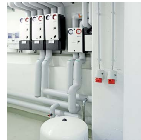
Energieeffiziente Wärmeverteilung im Keller
