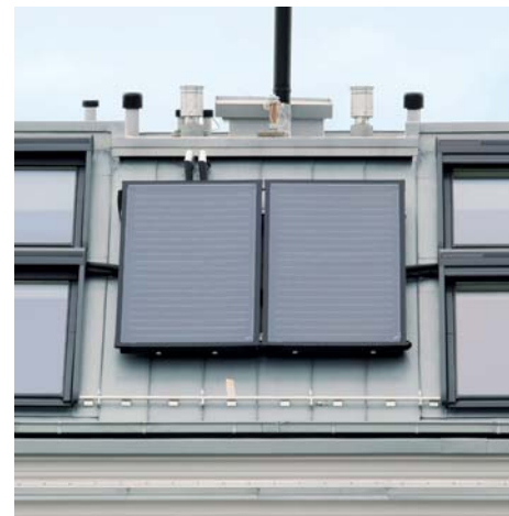
Solarthermie-Anlage auf dem Dach
