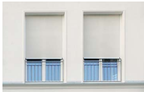
Fenster mit frei regulierbarem Sonnenschutz auf der Südseite
